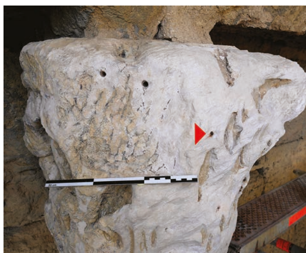
Figure 11 : chapiteau du deuxième ordre du retour latéral ouest. Mortaises circulaires vestiges d'une réparation. Signalé par la flèche, le vestige d'une tige métallique en place.
