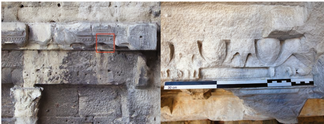
Figure 17 : corniche du deuxième ordre du retour latéral ouest. Retaille d'une section de la moulure de perles et pirouettes. À droite, le détail de la zone encadrée en rouge à gauche. À gauche, ortho-image M. Seguin (SRA Corse).
