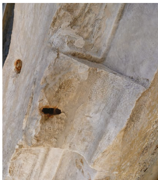
Figure 10 : corniche du deuxième ordre latéral ouest. Mortaise circulaire, vestige de la réparation d'un modillon.
